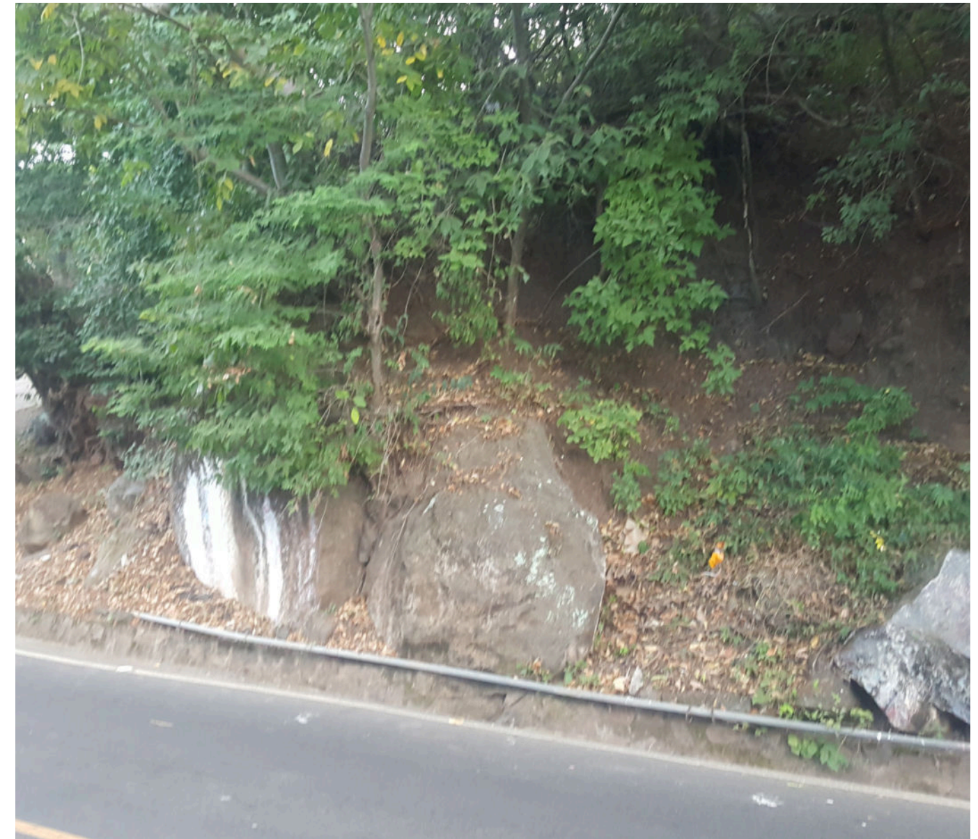
Figura 180. Zona con amenaza de deslizamiento y derrumbes, ladera este del volcán de Conchagua Fuente: MARN, 2019
